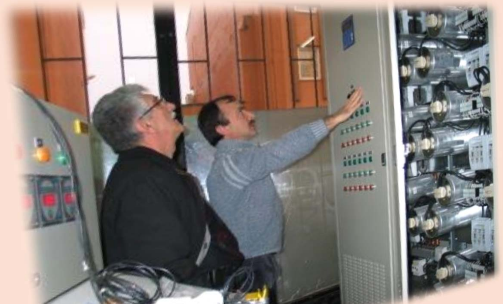
Atölyemizde Siemens Mühendisi Tarafından Denetlenen, Kompanzasyon Panosunun Rutin ve İzolasyon Testi.
